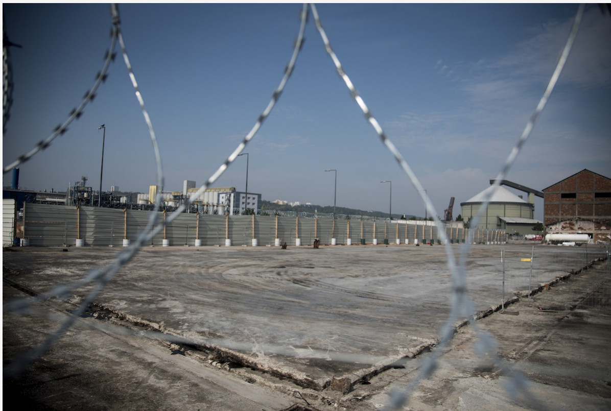
Dans l'usine Lubrizol de Rouen, le hangar où le feu s'est déclaré n'avait pas été reconstruit un an après, le 18 septembre 2020.
